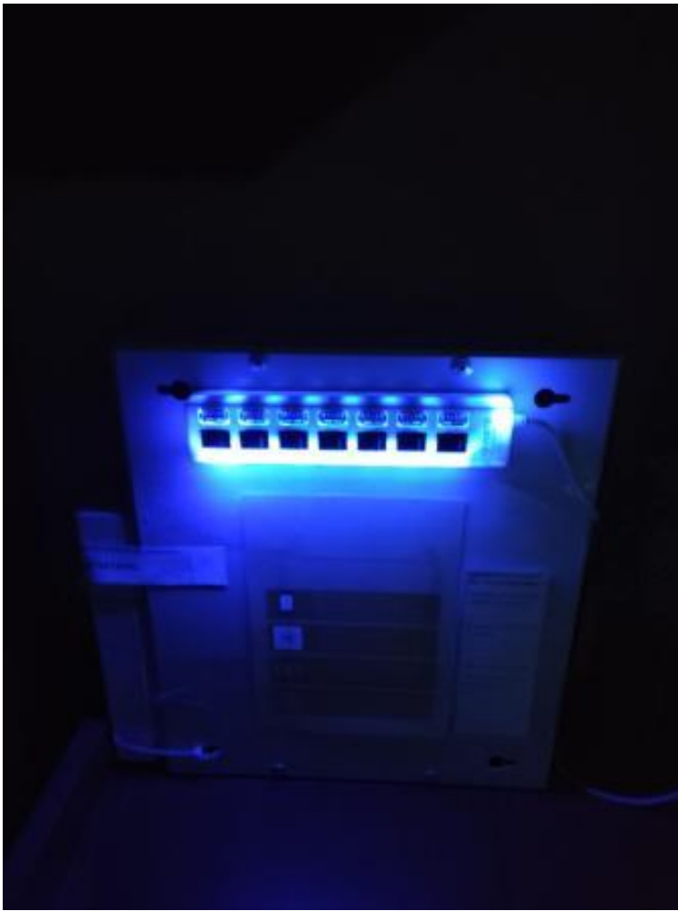
(Общий вид станции в темноте)
