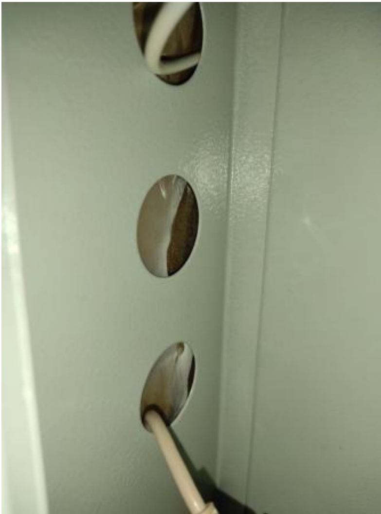
(Внутренний вид вывода проводов Станции)
