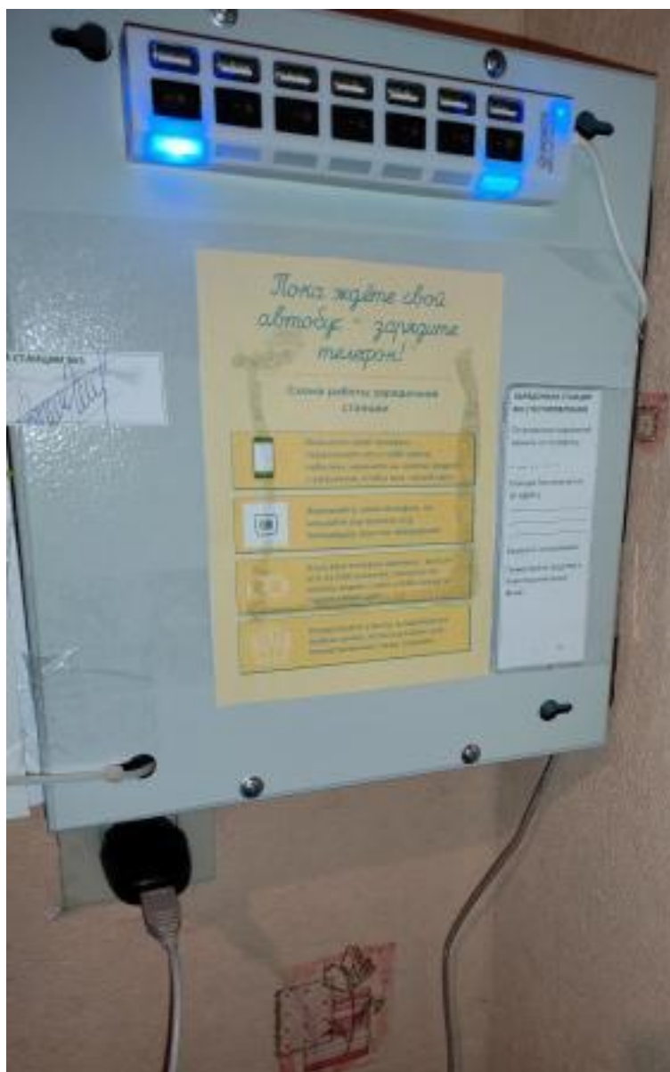
(Общий вид подключенной к электрической сети станции)
